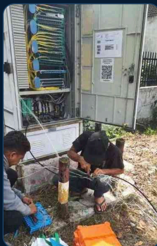
Terminasi kabel optik di kabinet, Medan Petisah
