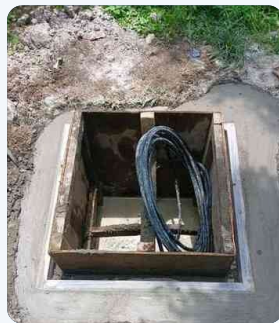
Handhole berisi kabel, Medan Belawan
