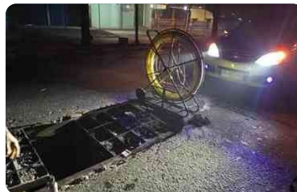
Haspel kabel optik di mulut manhole pada malam hari
